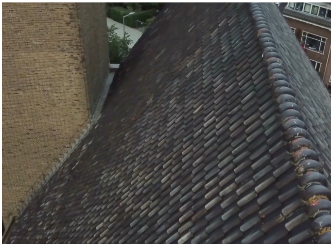
“...de oude dakpannen zijn aan vervanging toe...”
